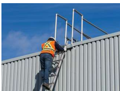
Les arceaux offrent une prise solide et les garde-corps dirigent le travailleur vers le centre du toit.
